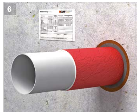
Bei Wänden sind die Brandschutzbänder von beiden Seiten einzubringen, bei Decken nur von unten.
