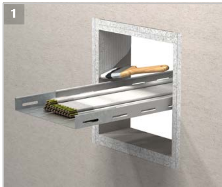
1 Die Öffnung reinigen und alle losen Teile entfernen. Die Öffnungs-laibung mit der Brandschutzbeschichtung ROKU® MFC 200 beschichten.
