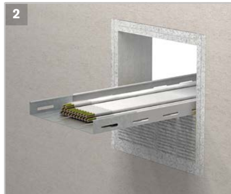
2 Die Kabel und Kabeltritsche mit ROKU® MFC 200 beschichten und die ROKU® MFP Mineralfaserplatten beidseitig der Wand bzw. Decke einpassen.
